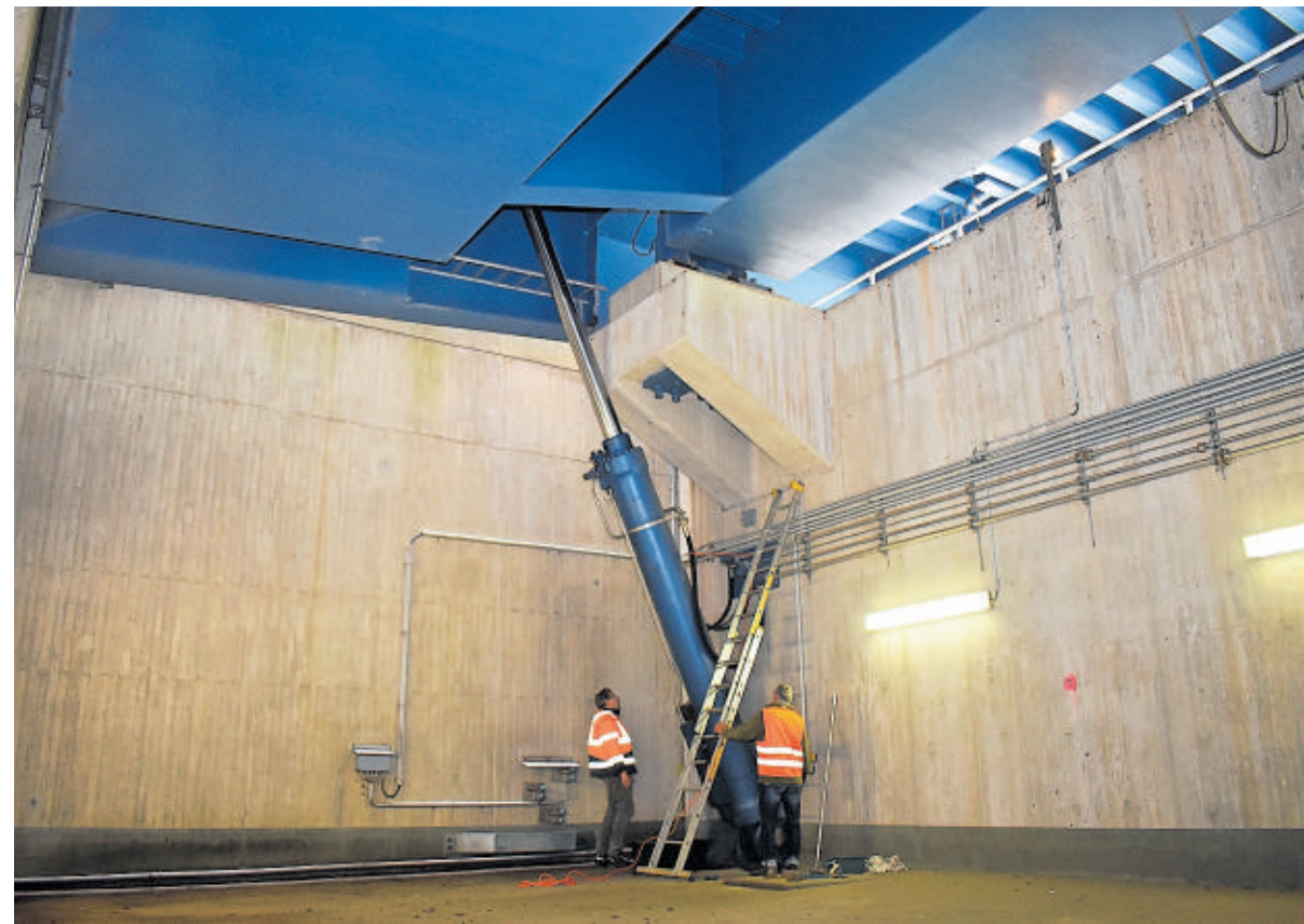
Blick in den Klappenkeller der Hove-Brücke: Auch der Hauptzylinder der Brücke wird gewartet, links oben ist das 120 Tonnen schwere Gegengewicht zu sehen. Fotos Vasel
