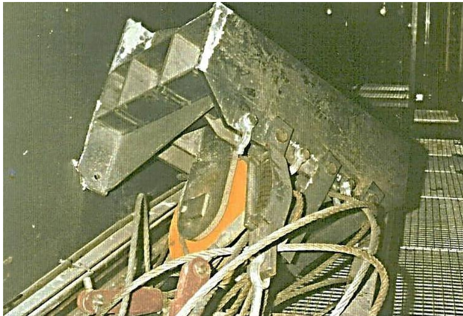
Abb. 31: Theaterbau, Unfall Bühnentechnik
