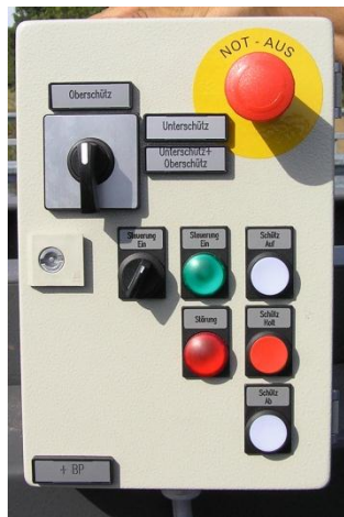
Abb. 21: Handsteuergerät (falsche Beschriftung NOT-AUS, richtig NOT-HALT)
