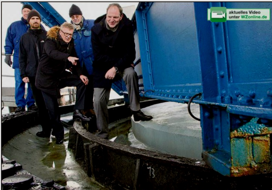
Schauten sich gestern den Schaden an (v.li.): Ralf Salinski (Projektleiter TBW), Dr. Gerald Ernst (Ingenieurbüro Schippke), Tim Menke (TBW-Betriebsleiter), Prof. Dr. Hans-Günther Schippke (Ingenieurbüro) und Stadtbaurat Oliver Leinert. WZ-Foto: LÜBBE
