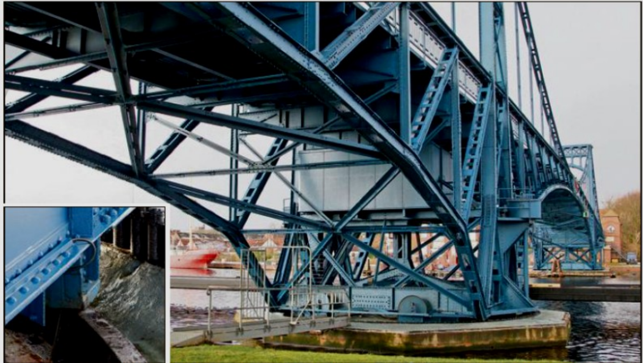
Der Südflügel der KW-Brücke (großes Bild vorne) hängt herunter. Die Stützböcke (kleines Bild, blau) liegen direkt auf dem Laufrad (kleines Bild, schwarz); eigentlich müssten sie frei beweglich sein.
